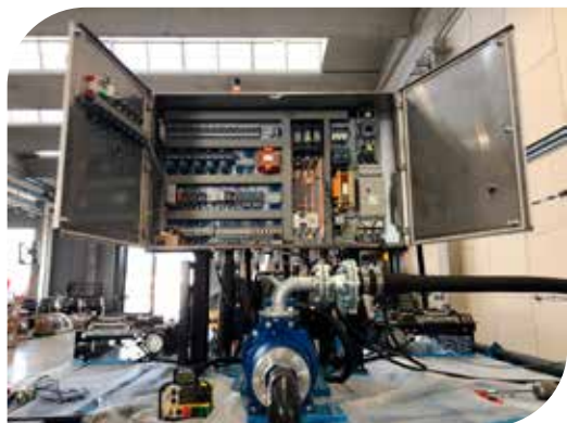
Pannello di controllo elettrico
